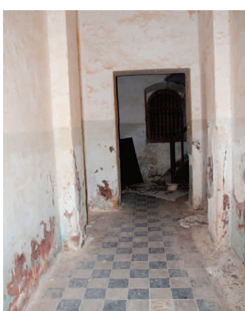
Στον όροφο στους διαδρόμους... παντού εγκατάλειψη.
