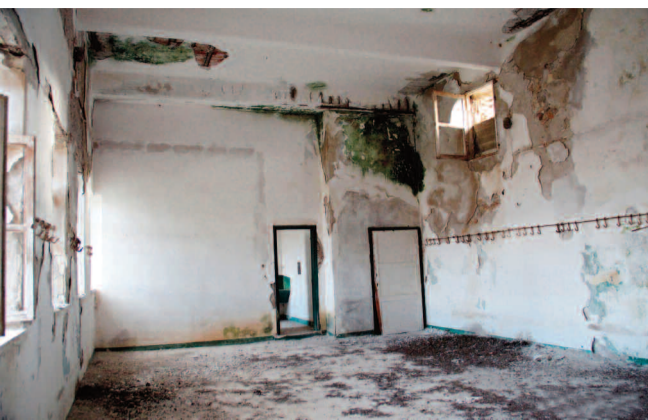
Στον όροφο στους χώρους υγιεινής... παντού εγκατάλειψη.
