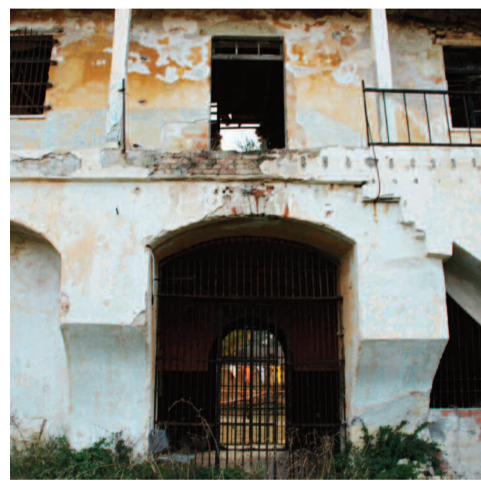
Είσοδος για τον όροφο του κτηρίου και την εκκλησία του Αγίου Ελευθερίου. Σήμερα είναι κλειστή λόγω της ετοιμορροπίας...
