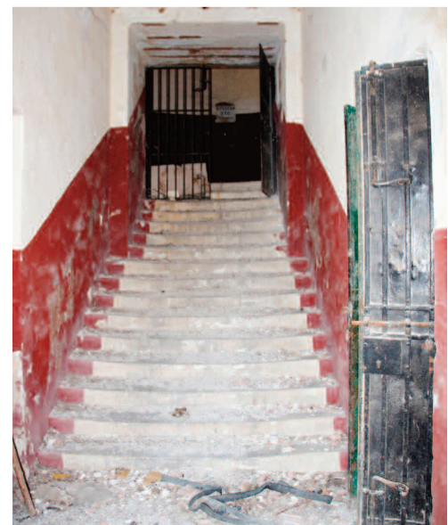
Ανεβαίνοντας στον όροφο... και εδώ εγκατάλειψη...
